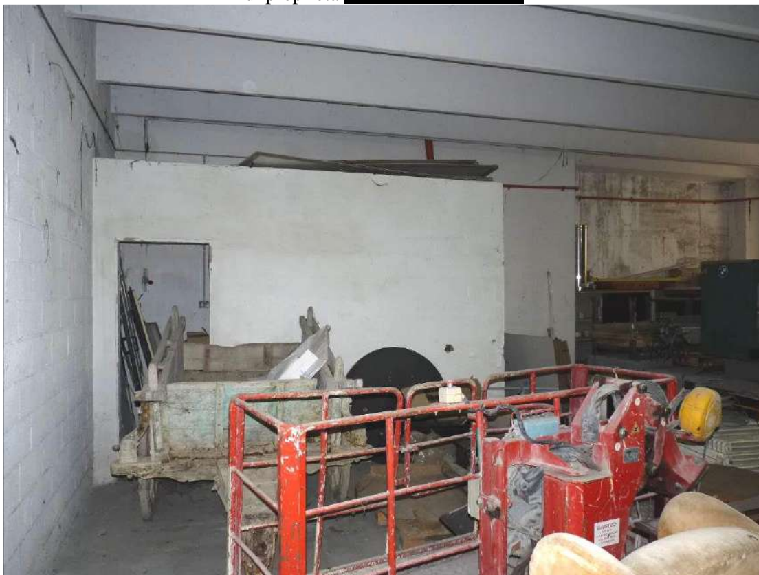
Foto alleg. n°4 – Locale magazzino (sub.49) (porzione opposta a zona di ingresso: zona w.c.) di proprietà ██████████
