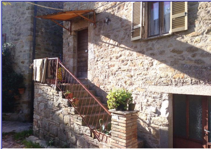
Foto 4 - Si accede all'abitazione per mezzo di una scala esterna. Al piano terra si accede ai fondi.
