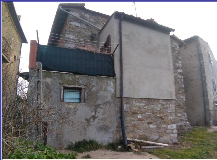
Foto 10 - Sul retro dell'edificio sono presenti delle adduzioni oggetto di ordinanza di demolizione.
