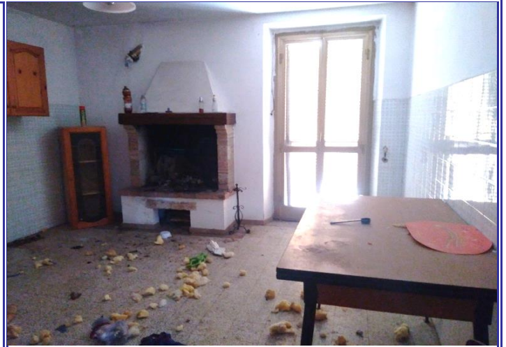
Foto 35 - Altra stanza del piano 1°. L'appartamento necessita di ampia ristrutturazione e rifacimento
