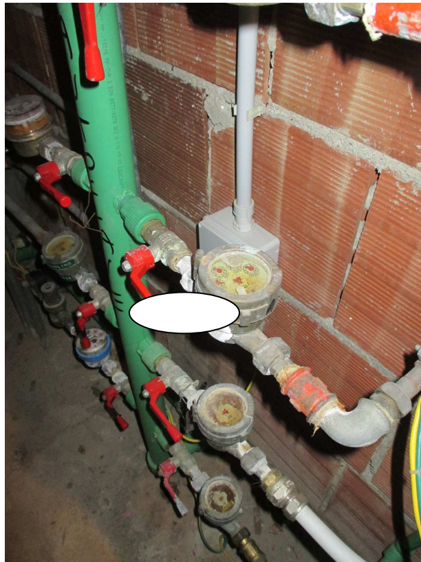
foto 30 – Piano Garage - Particolare Contatori Acqua.
