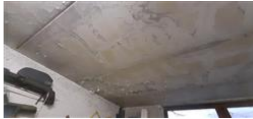
Danni da umidità
