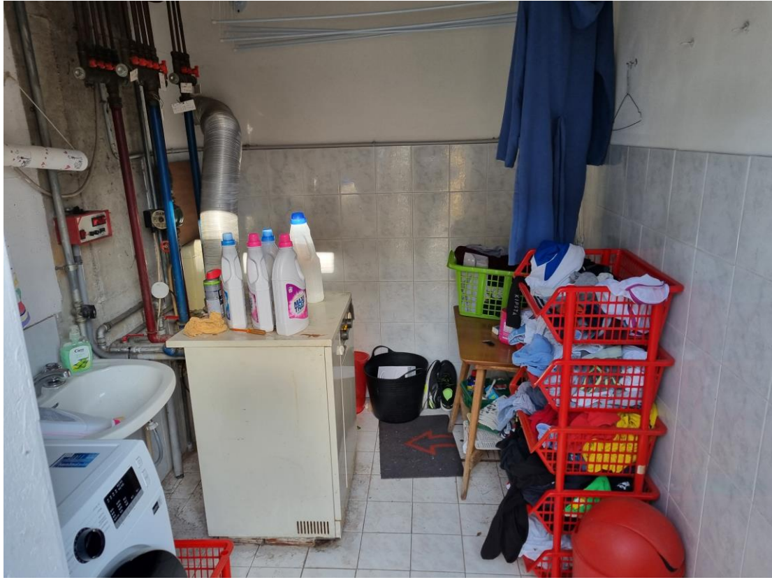
VISTA INTERNA - CENTRALE TERMICA (BCNC)
