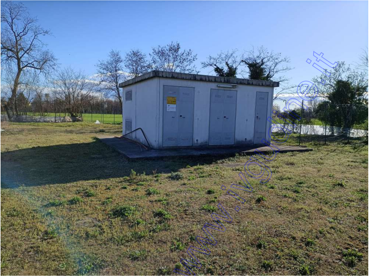
nuova cabina elettrica
