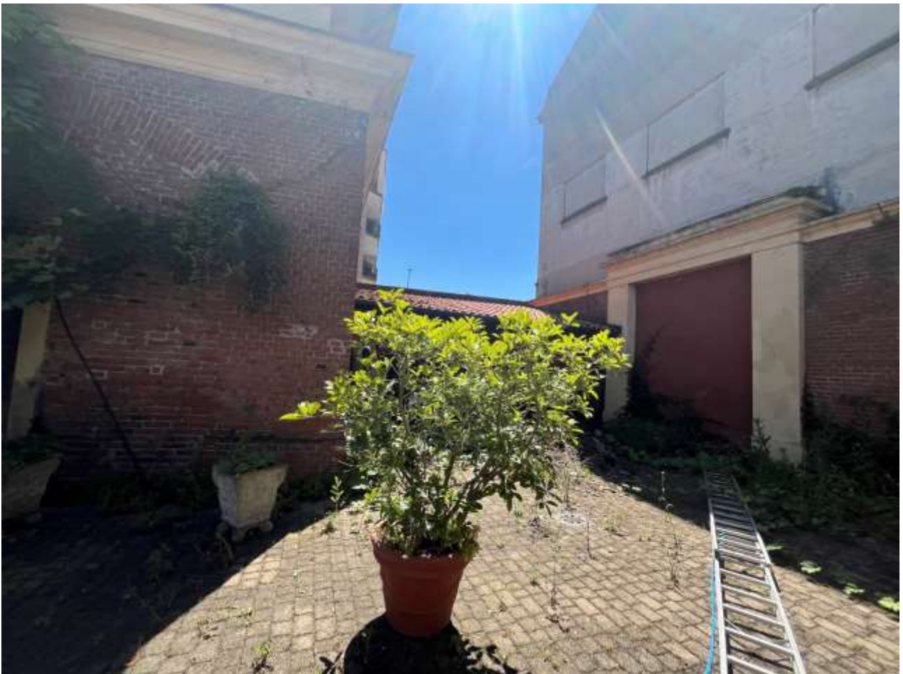
Interno corte – Tettoia non autorizzata adiacente a Palazzina F3
