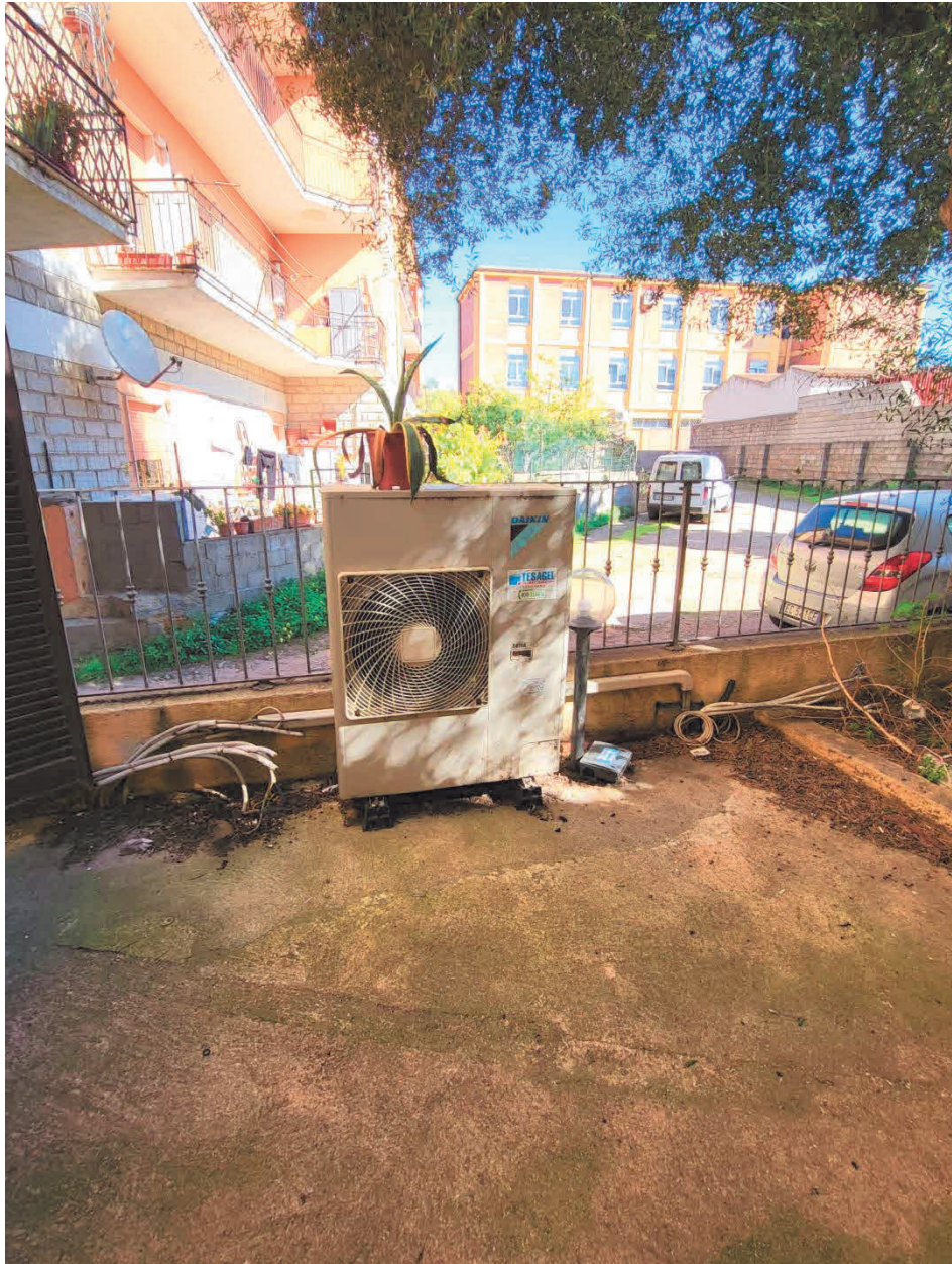
Pompa di calore in area condominiale
