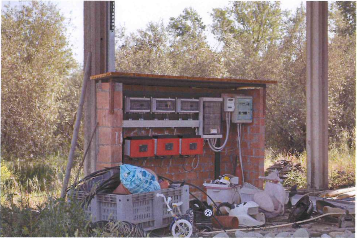
31. Dettaglio quadri impianto fotovoltaico
