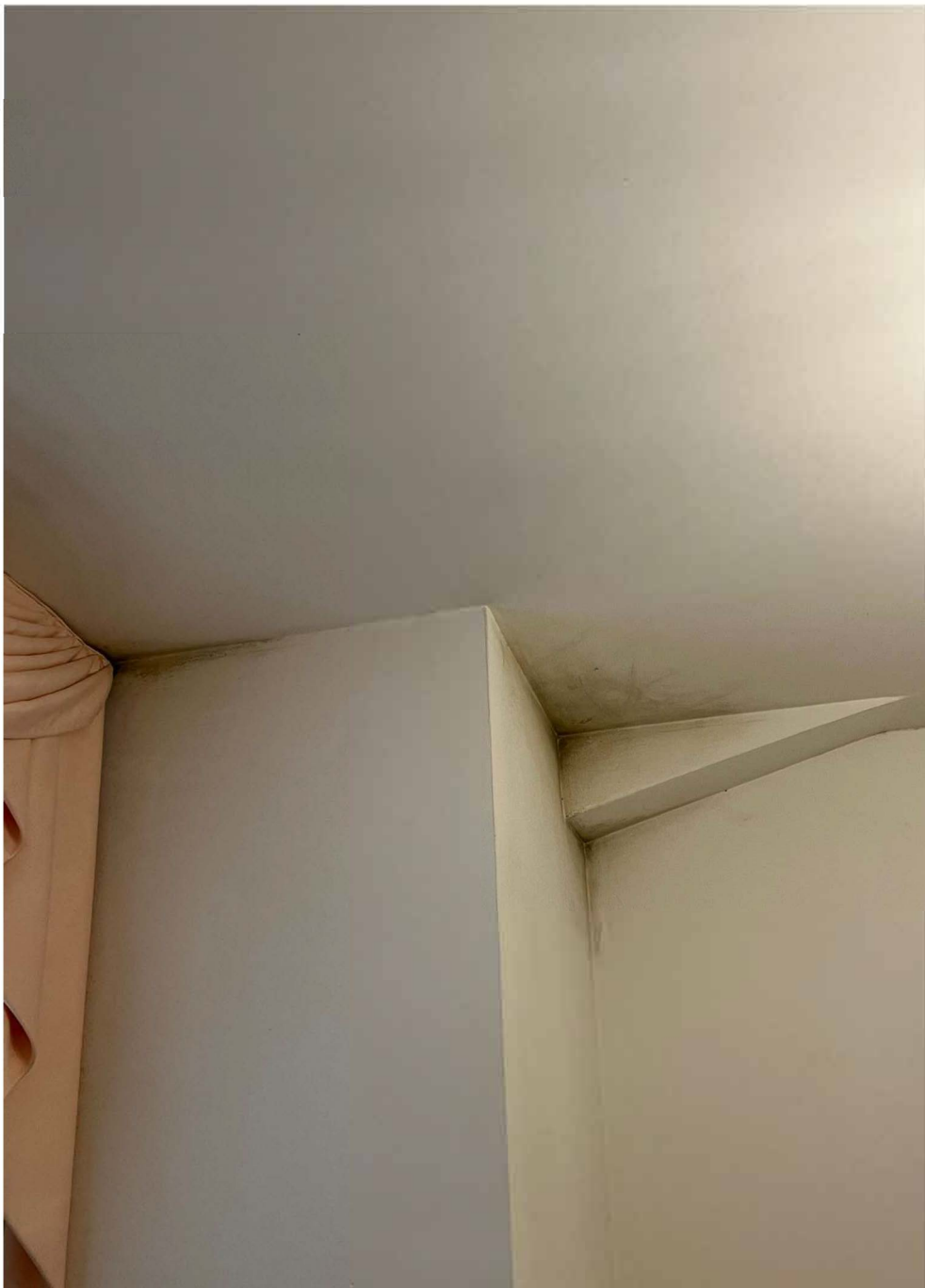
DANNI CAUSATI DA INFILTRAZIONI D'ACQUA - CAMERA 1
