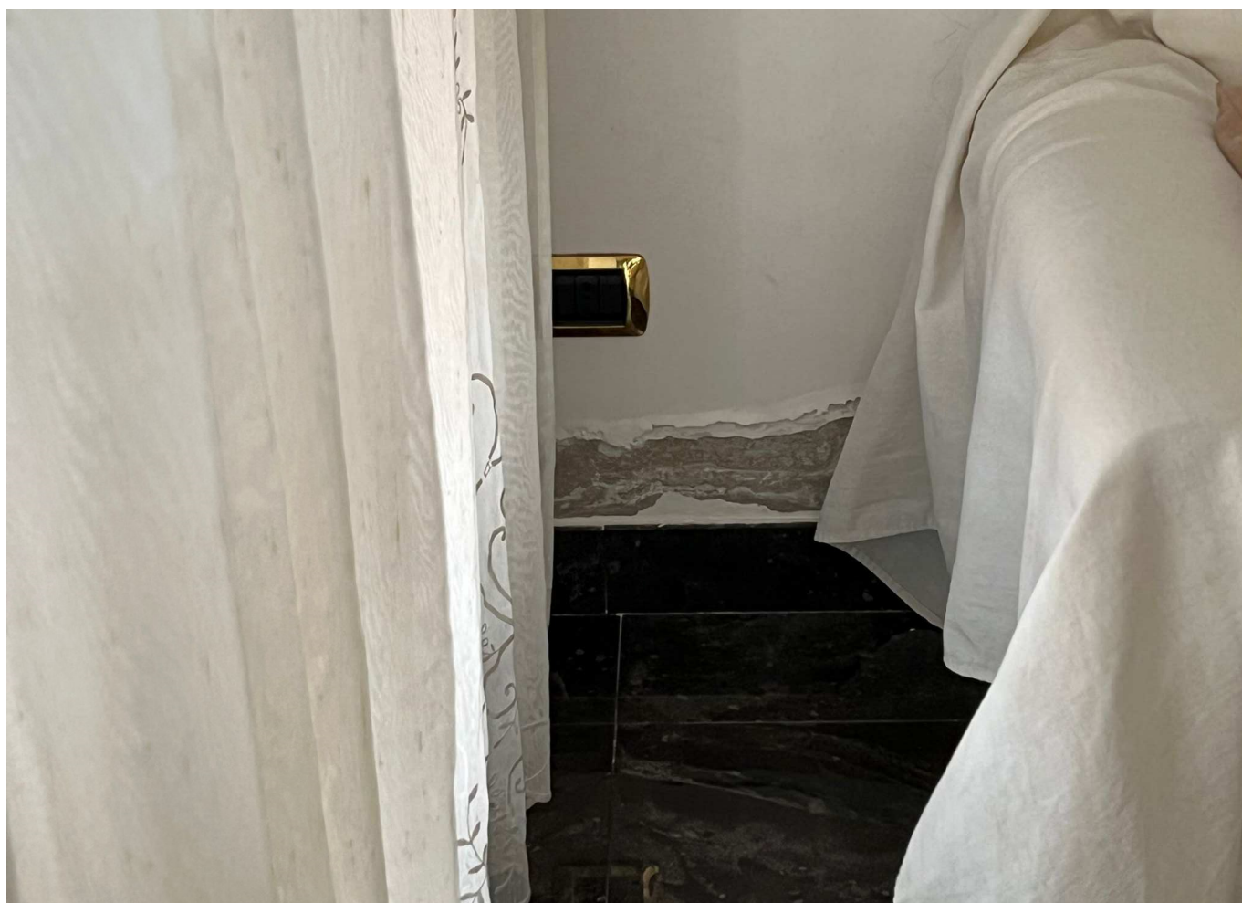
DANNI CAUSATI DA INFILTRAZIONI D'ACQUA - SOGGIORNO VISTA 2
