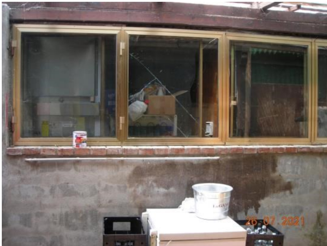
AMPLIAMENTO CUCINA ABUSIVO
