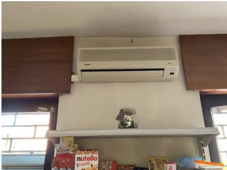
Condizionatore a parete
