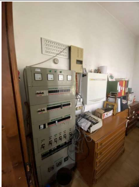
133. Quadro elettrico al PT
