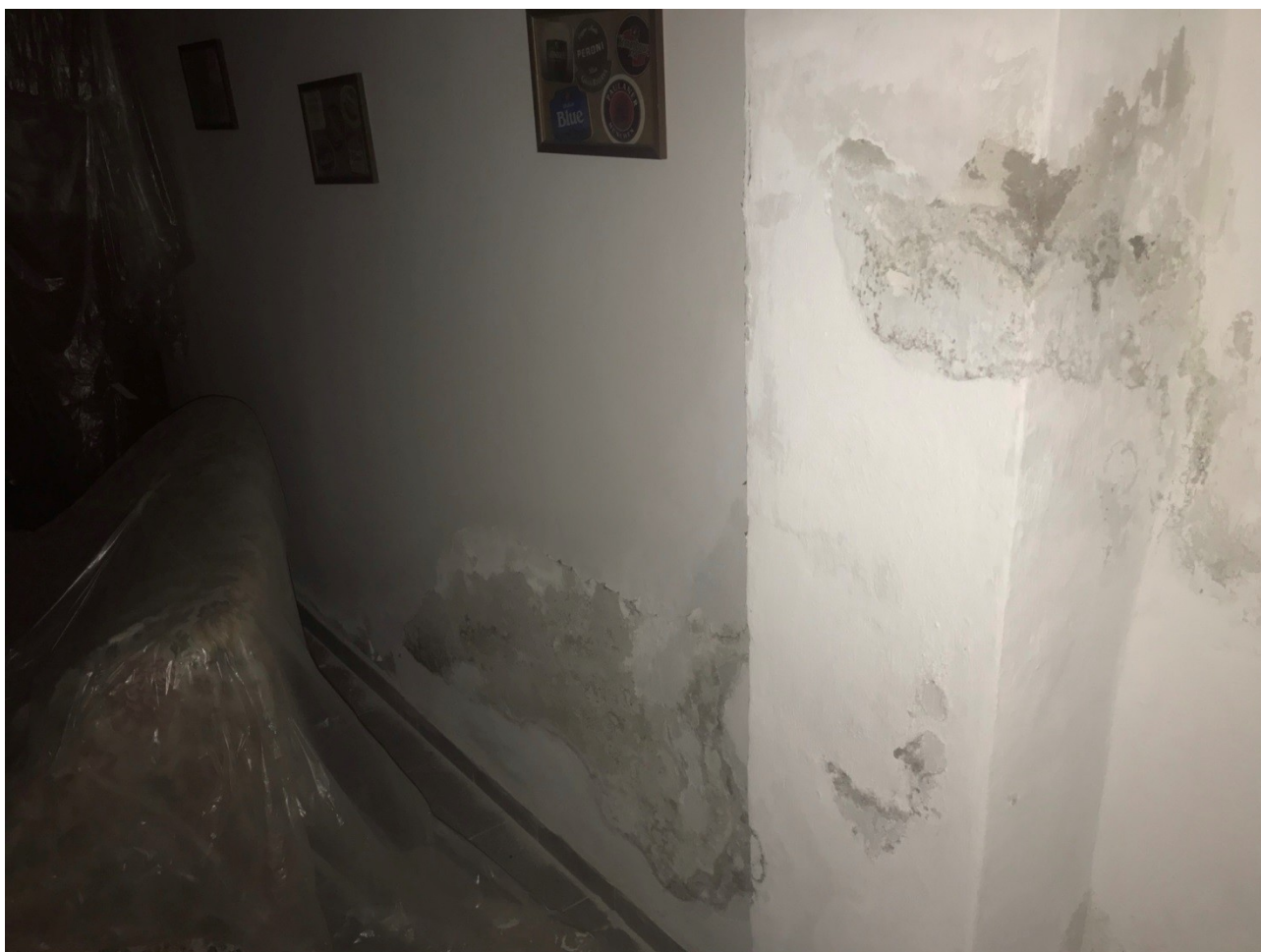
Vista efflorescenze di umidità piano seminterrato
