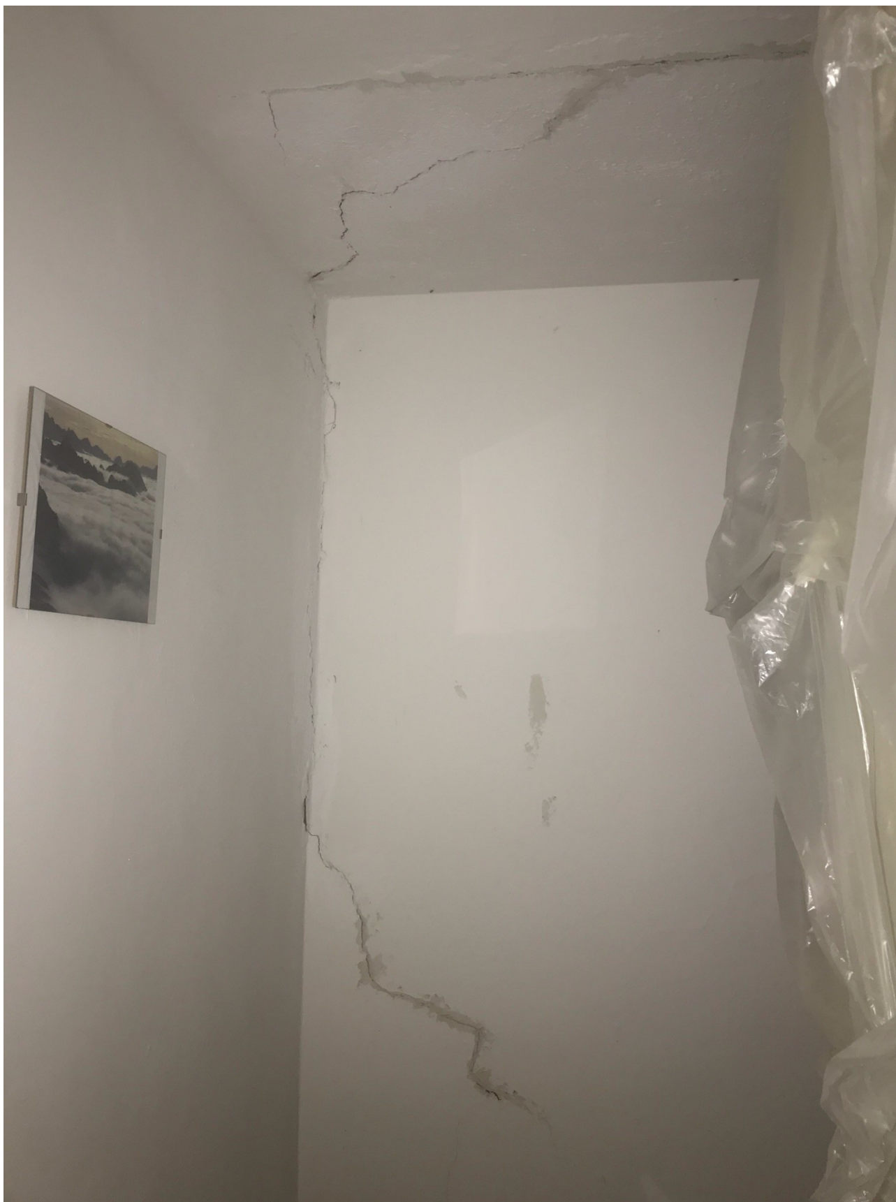
Vista lesione parete di sinistra camera da letto
