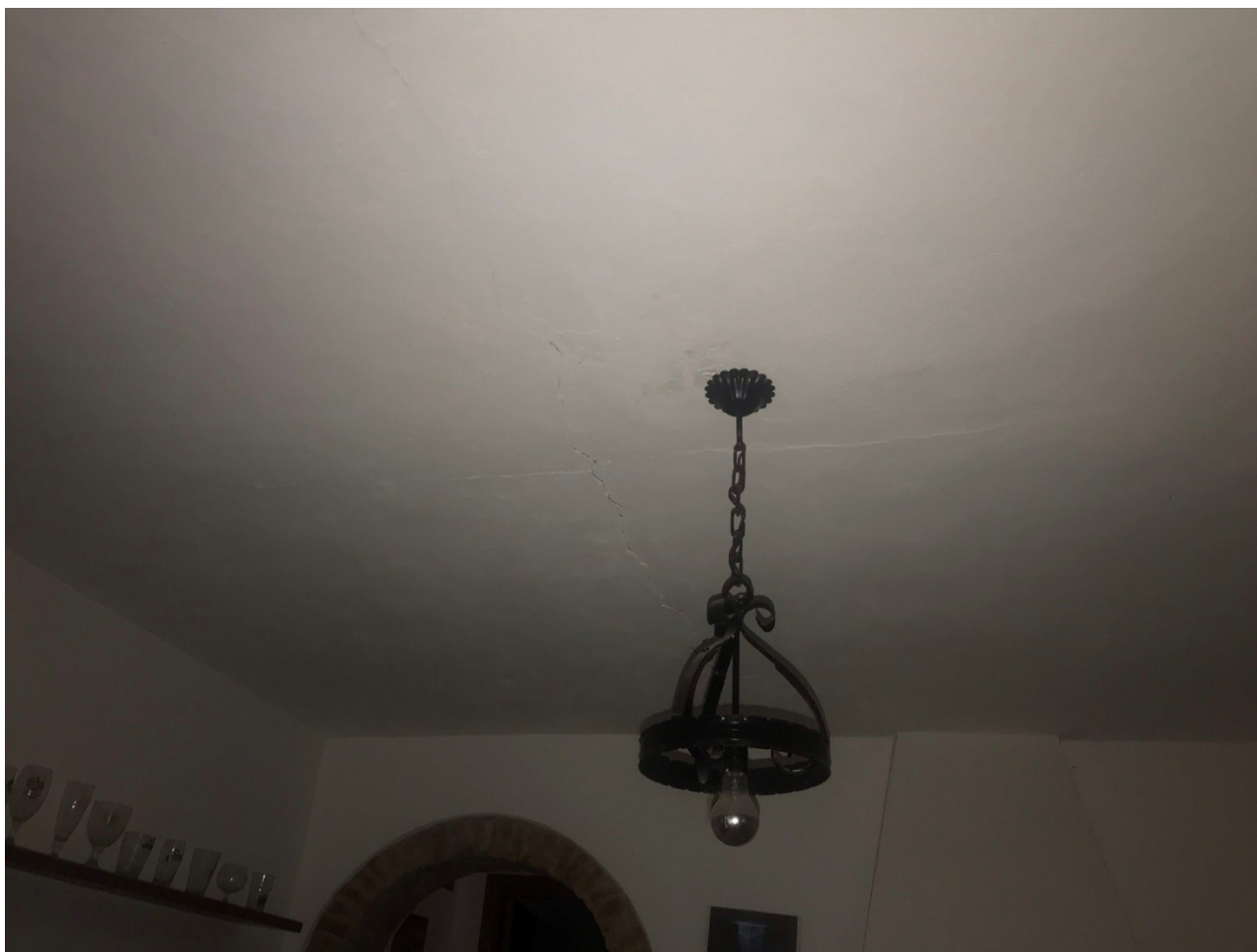
Vista lesioni soffitto piano seminterrato
