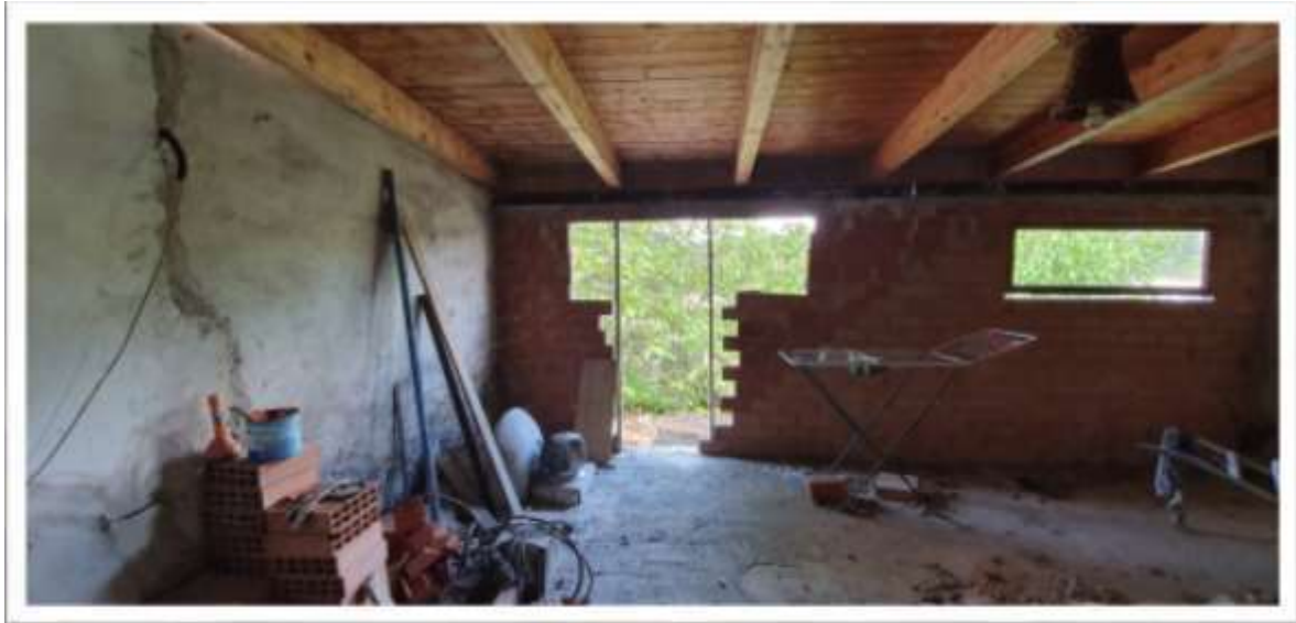
Foto 7 – Locale ex terrazzo con annesse opere edilizie realizzate in assenza di titolo abilitativo
