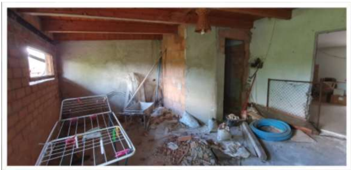
Foto 8 – Locale ex terrazzo con annesse opere edilizie realizzate in assenza di titolo abilitativo (si noti assenza vano scala indicato catastalmente)
