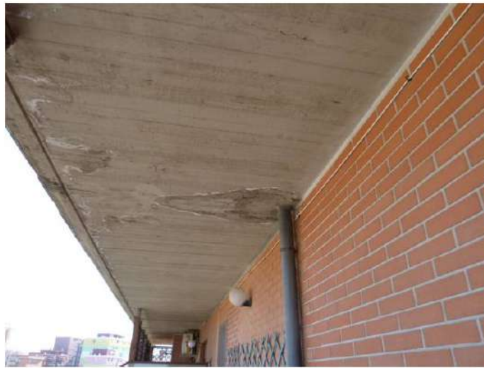
Foto n. 10 – Una doppia perdita di acqua piovana in atto, proveniente dal discendente condominiale, all'altezza del piano superiore.
