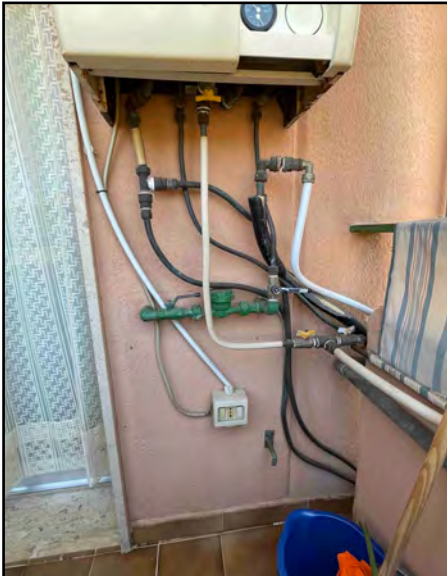
Caldaia sul balcone
