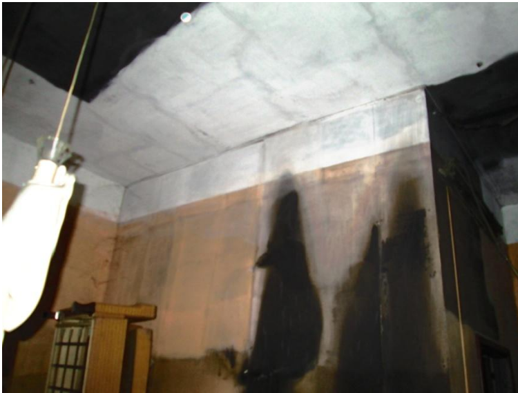
Foto 6 Tracce dell'incendio nella bottega
