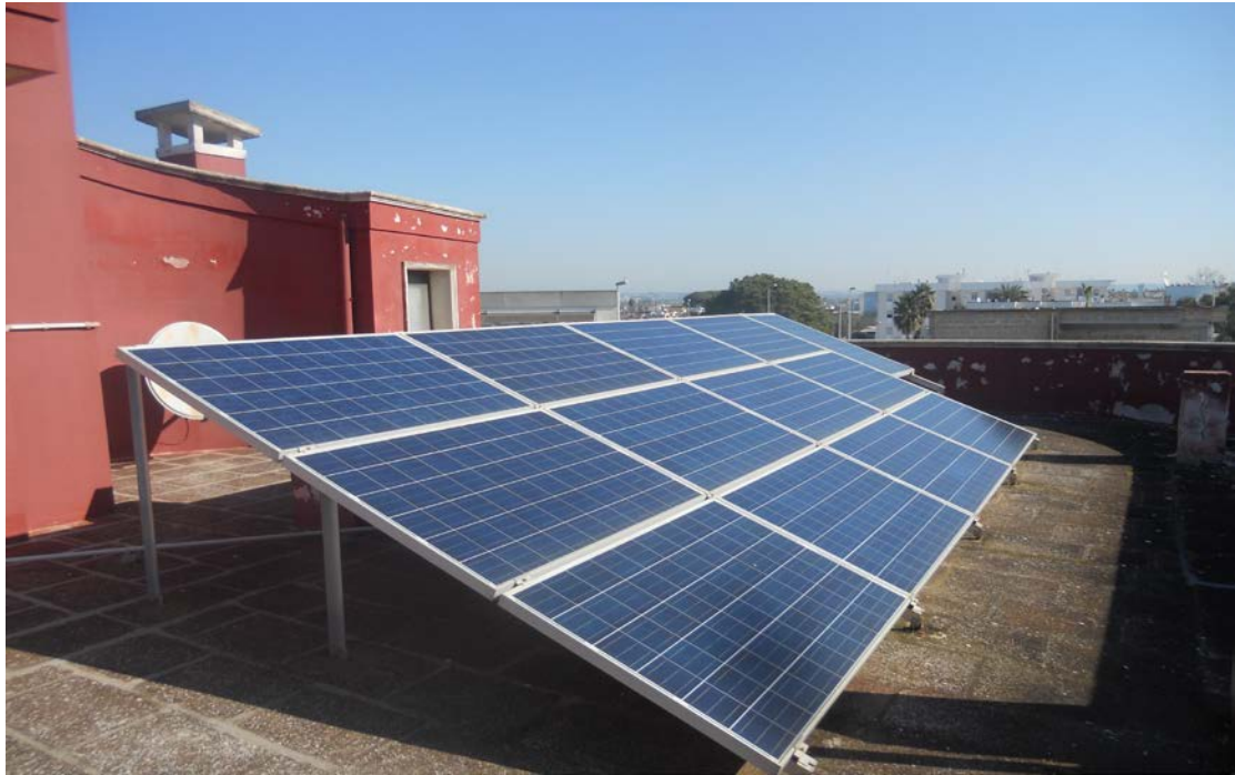
FOTO N.10 PARTOLARE IMPIANTO FOTOVOLTAICO
