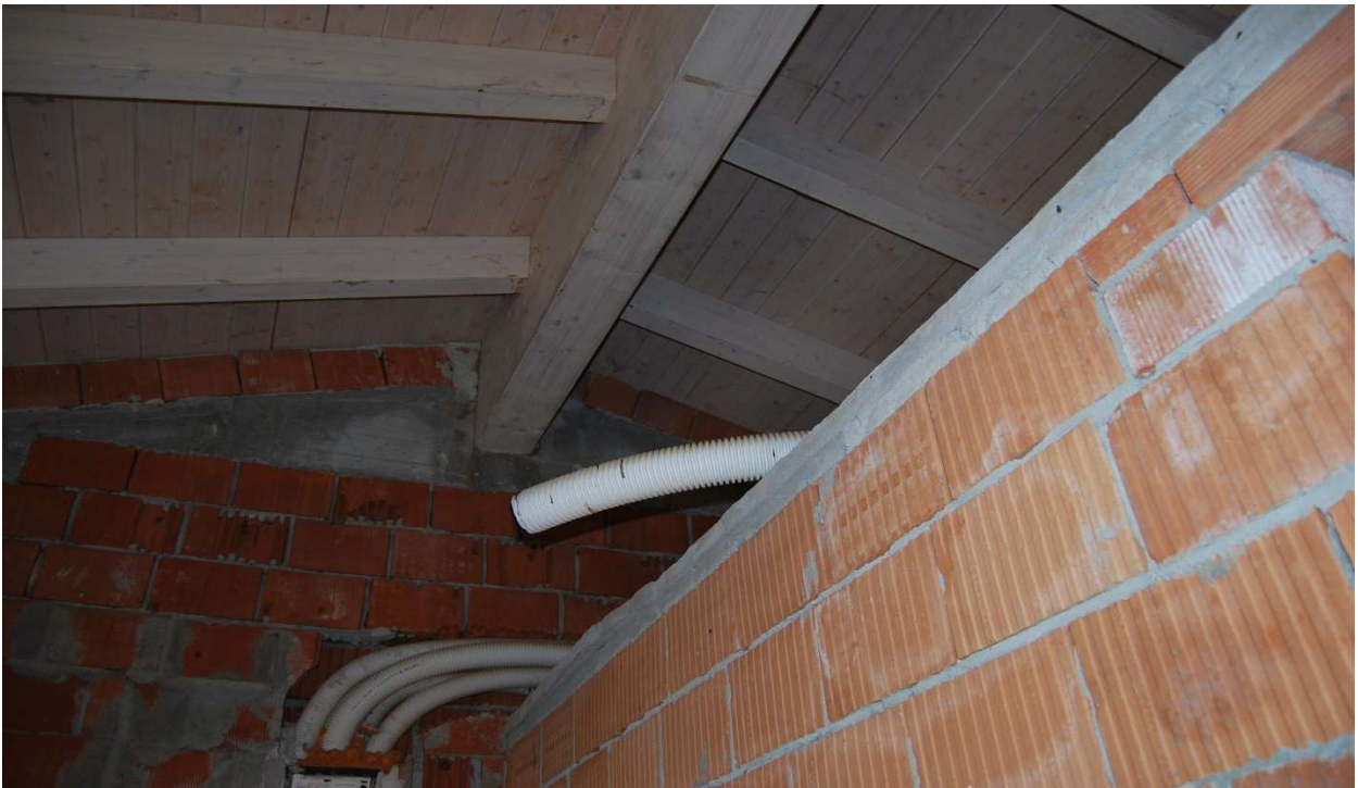
Bagni e tetto a vista in legno lamellare con isolamento termico al P 1° , via Kennedy, Quargento (AL) foto 17-18)
