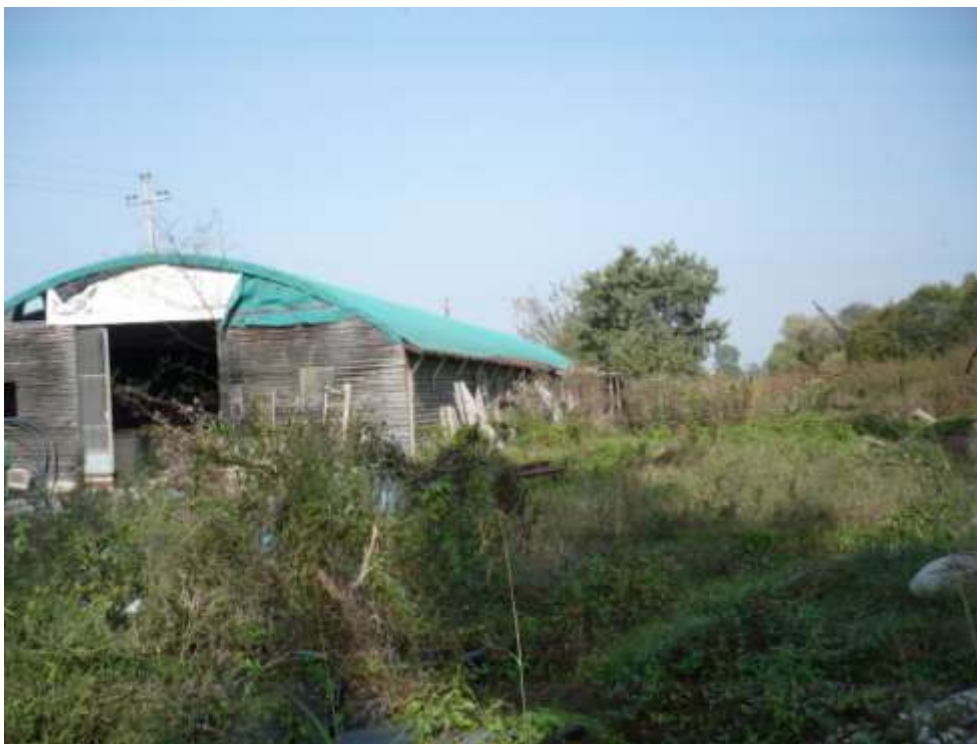
Locale uso stalla/ricovero attrezzi in legno dimensioni ml 9,50 x ml 32,00 Pavimentazione in getto e copertura con struttura in ferro e teloni in pvc Opera abusivamente realizzata da demolire PROSPETTO SUD
