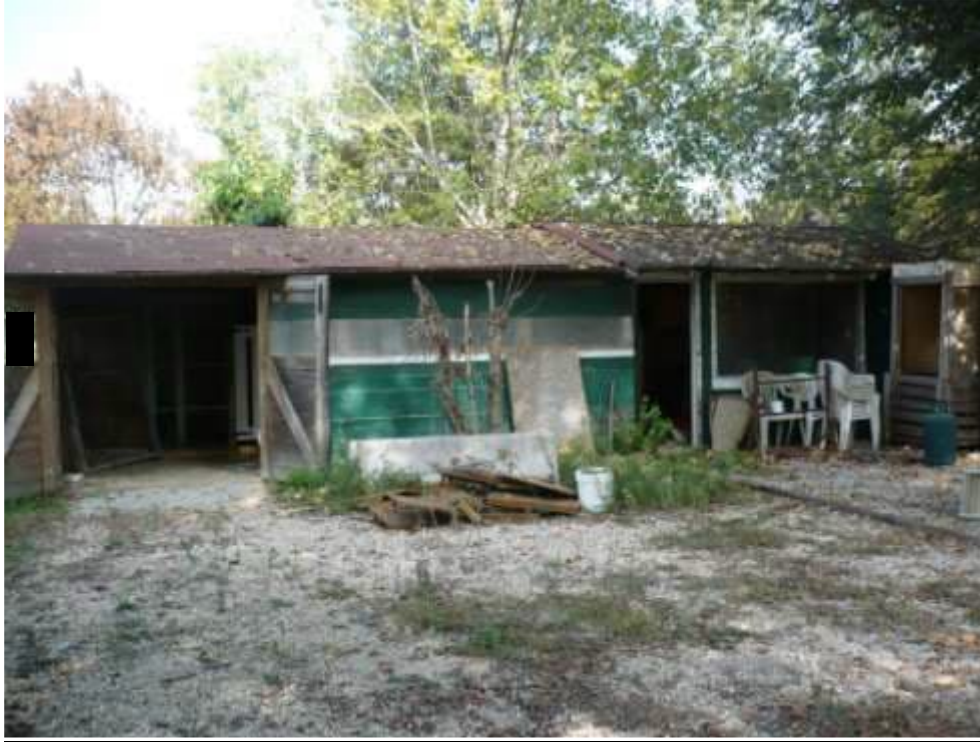
Locale ricovero attrezzi in legno dimensioni ml 4,20 x ml 11,00 Opera abusivamente realizzata da demolire PROSPETTO EST
