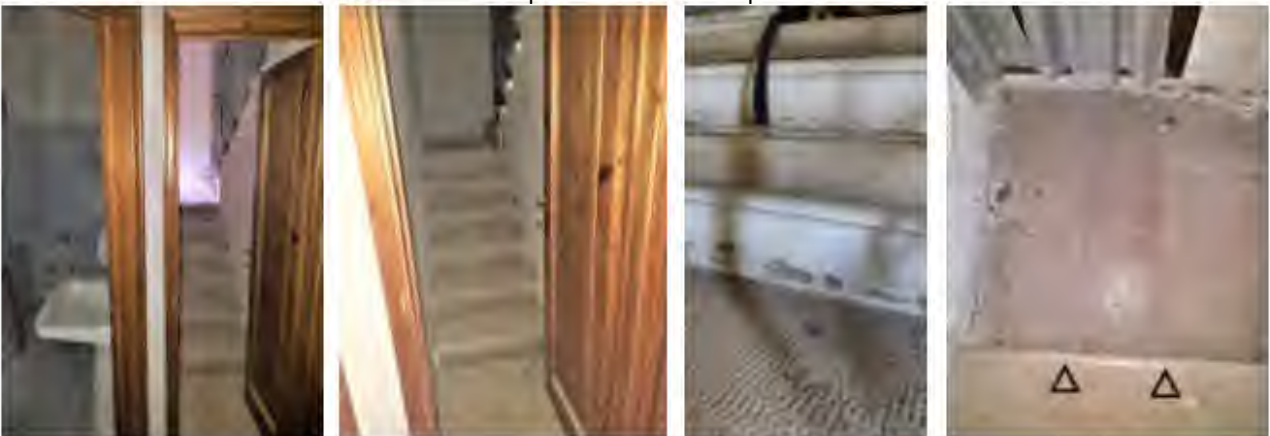
Figura 4 PARTICOLARI DELLE SCALE E ALTERAZIONI SUBITE
