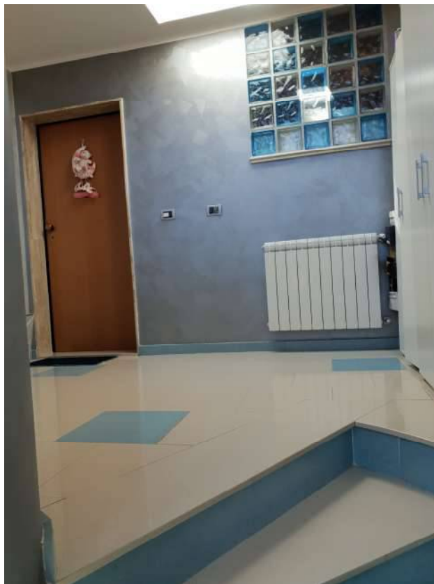
Foto n ° 62 – Piazzuola di arrivo al piano terzo ove insiste il sub 5
