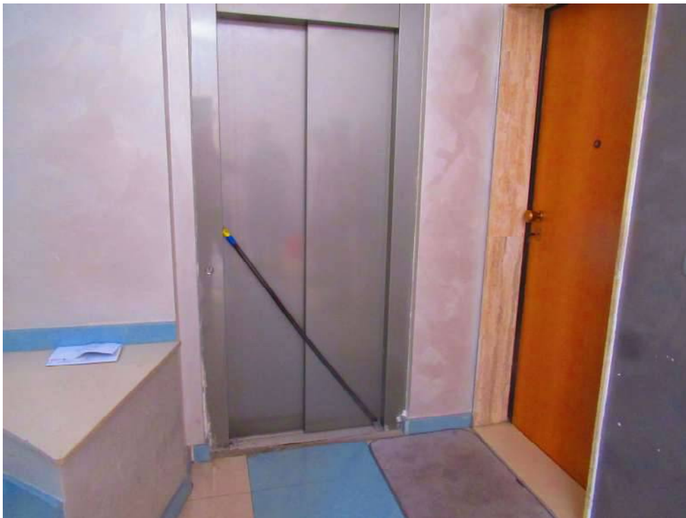
Foto n ° 86 – Ascensore al piano S1. –
