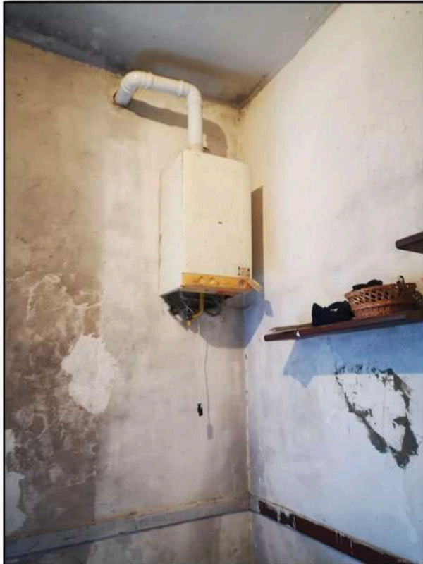
8. CALDAIA IN CUCINA
