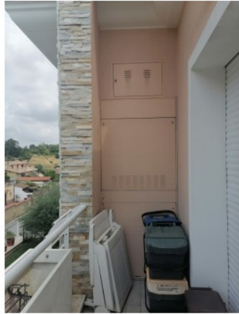
balcone vista nicchia caldaia
