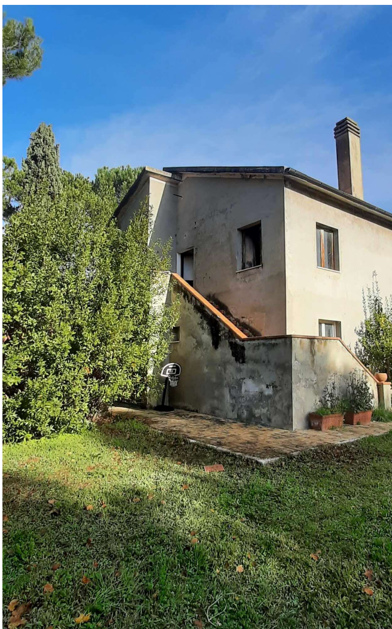
Foto 1 – Fabbricato esterno angolo sud-ovest, rampa di scale di accesso all'unità immobiliare urbana (u.i.u.)
