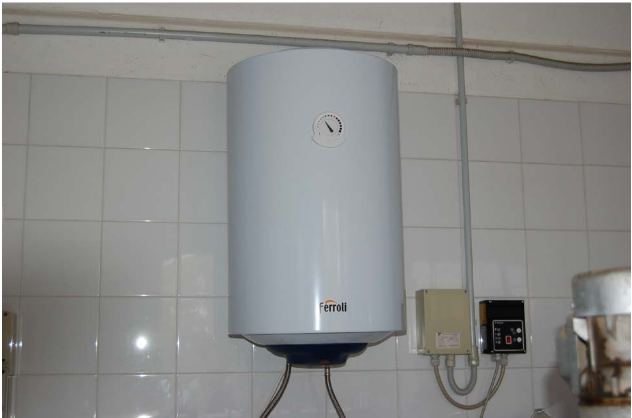
Foto 18 – Caldaia per la produzione di acs
