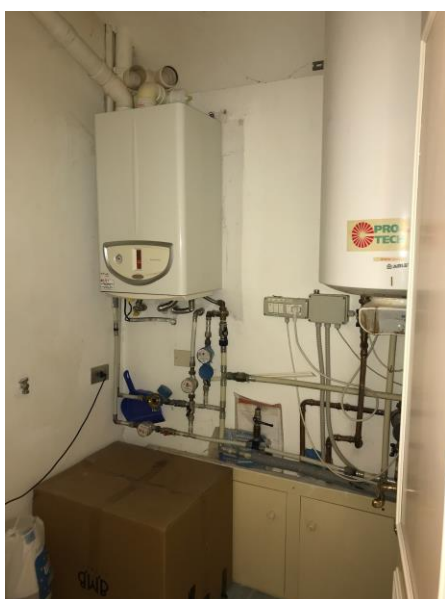
11- il locale caldaia
