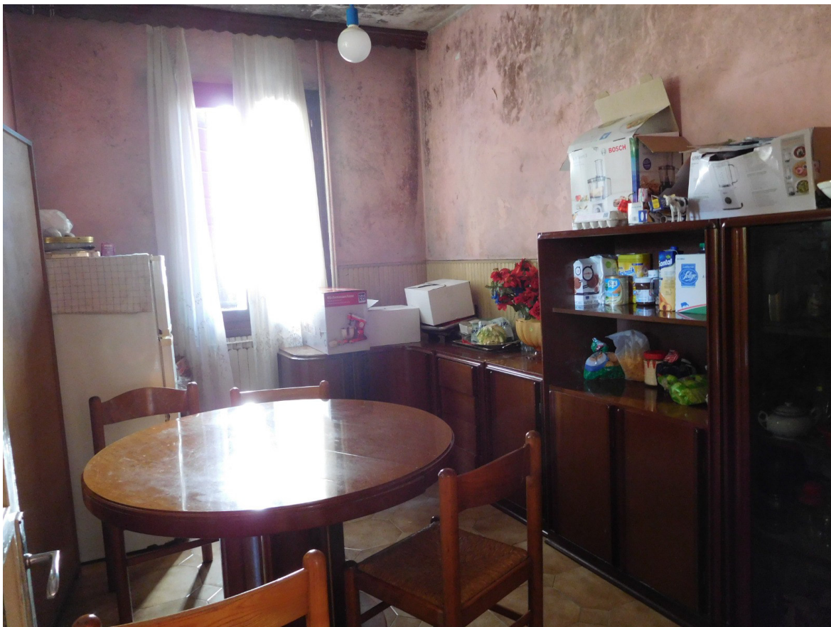
Stanza da pranzo in continuità con il soggiorno, presenza di muffe a soffitto e parete
