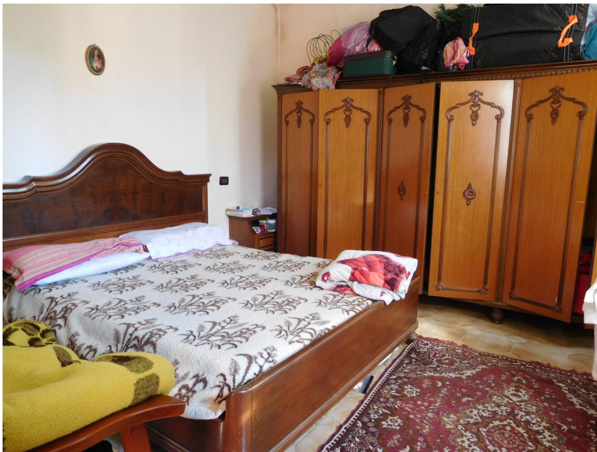
Camera da letto doppia presenza di muffe a soffitto e parete
