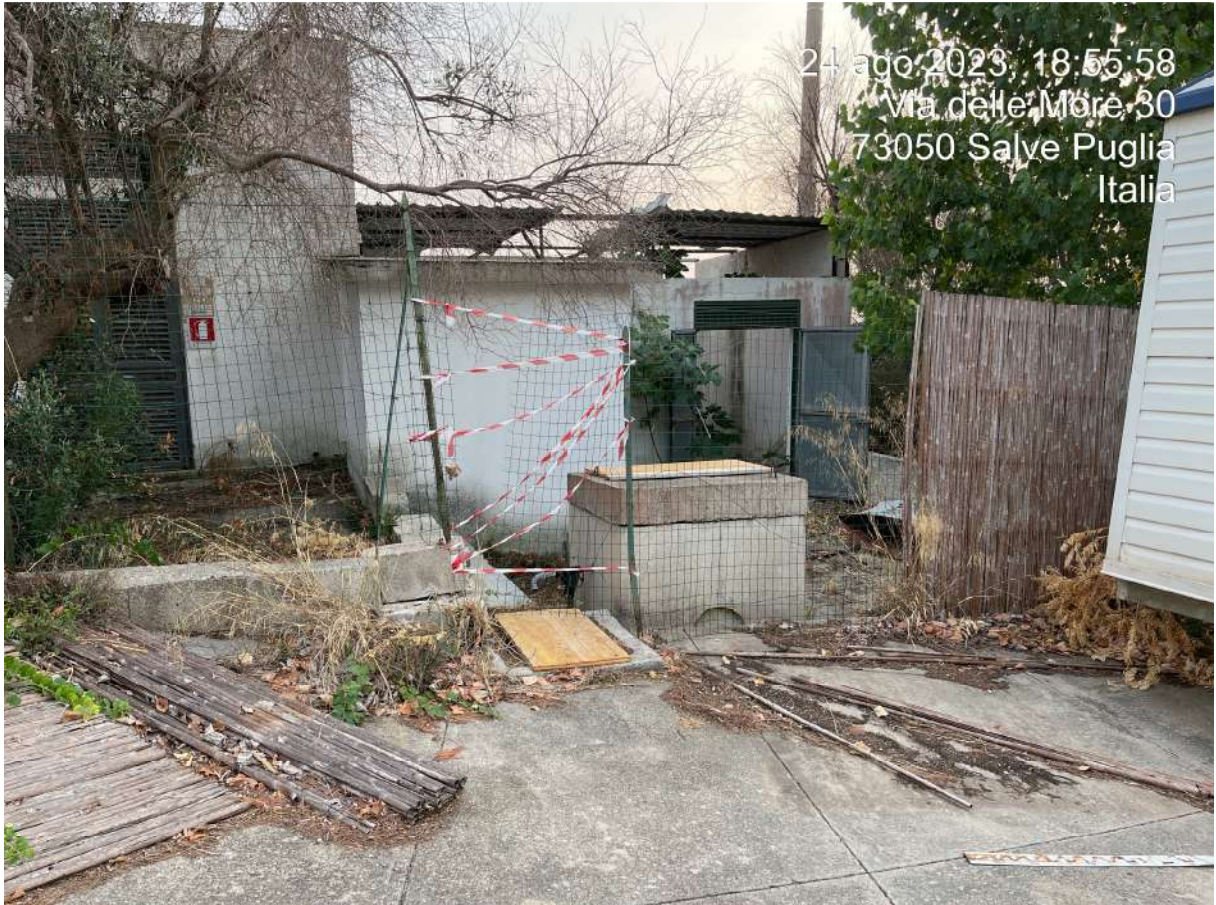
Locale cabina elettrica e gruppo elettrogeno - zona sud-est
