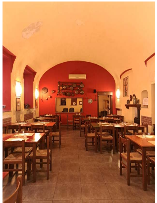
Figura 12- sala da pranzo, infiltrazioni sulle volte
