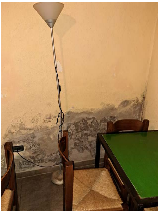
Figura 19- efflorescenze sala da pranzo
