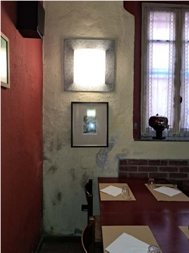
Figura 17- efflorescenze sala da pranzo
