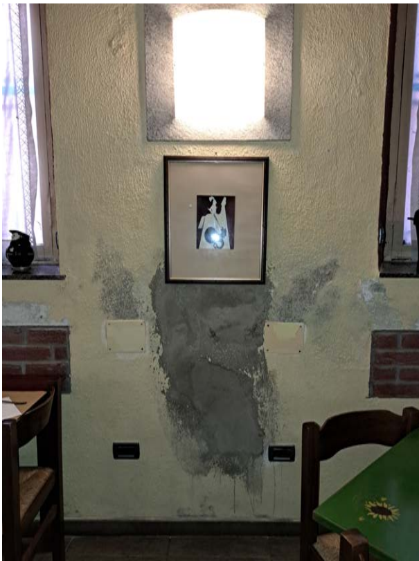
Figura 15- efflorescenze sala da pranzo
