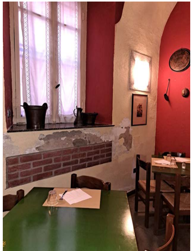
Figura 16- efflorescenze sala da pranzo
