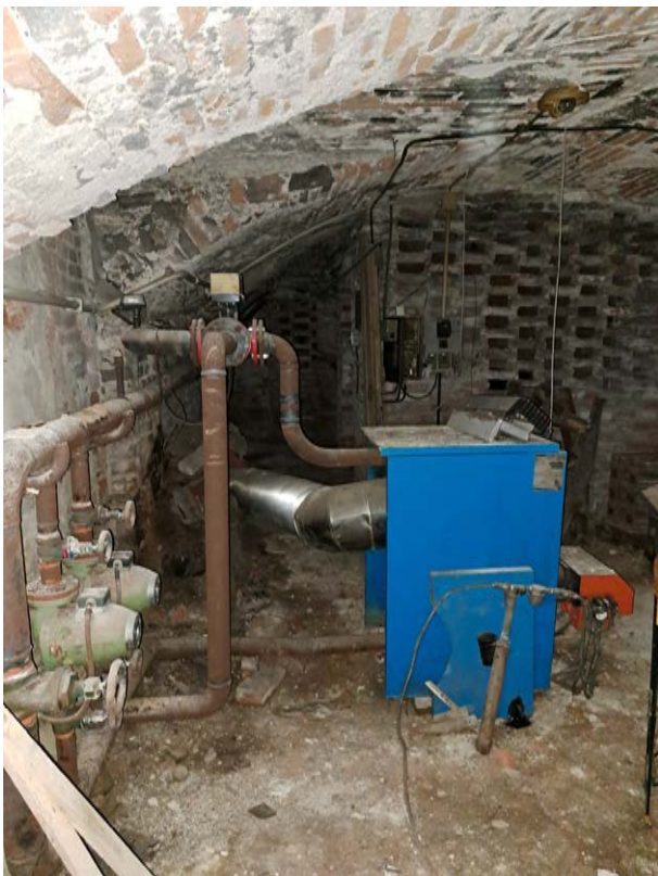
Figura 38- cantina - impianto dismesso
