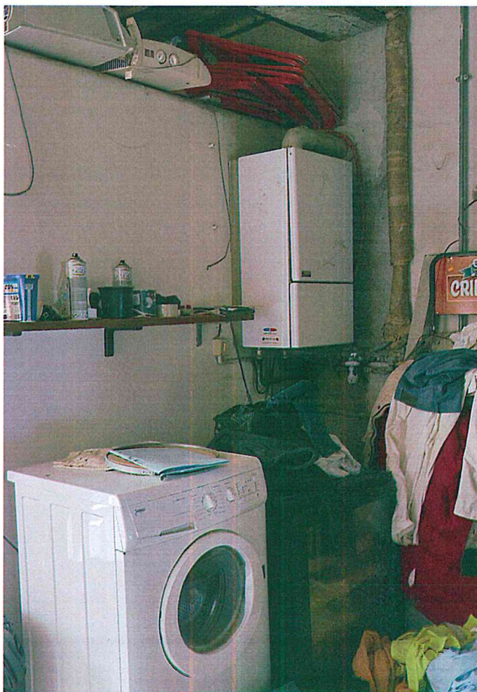
CALDAIA DI TERZI posta nel garage
