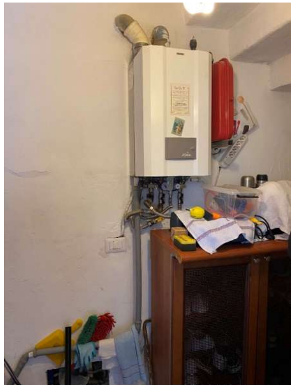
CALDAIA POSTA NEL SOTTOSCALA
