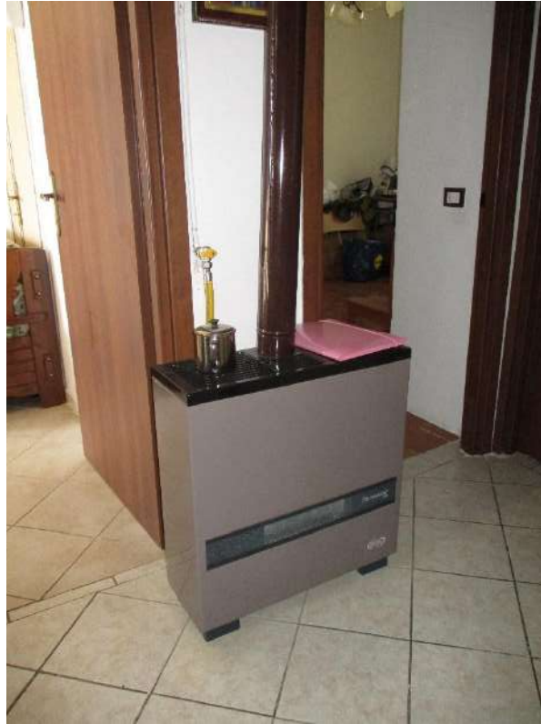
Sistema di riscaldamento autonomo con stufa a gas
