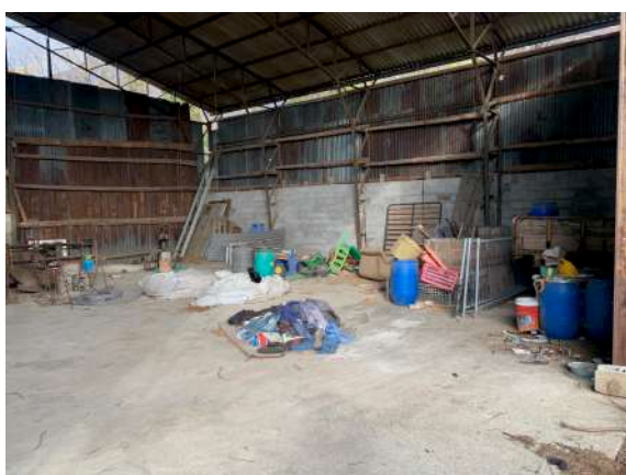
Deposito (parte abusiva de demolire).
