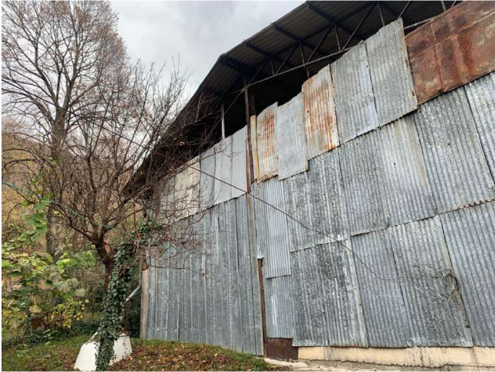
Deposito lato ovest (parte abusiva).
