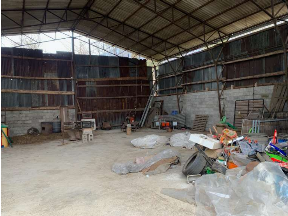
Deposito interno (parte abusiva).
