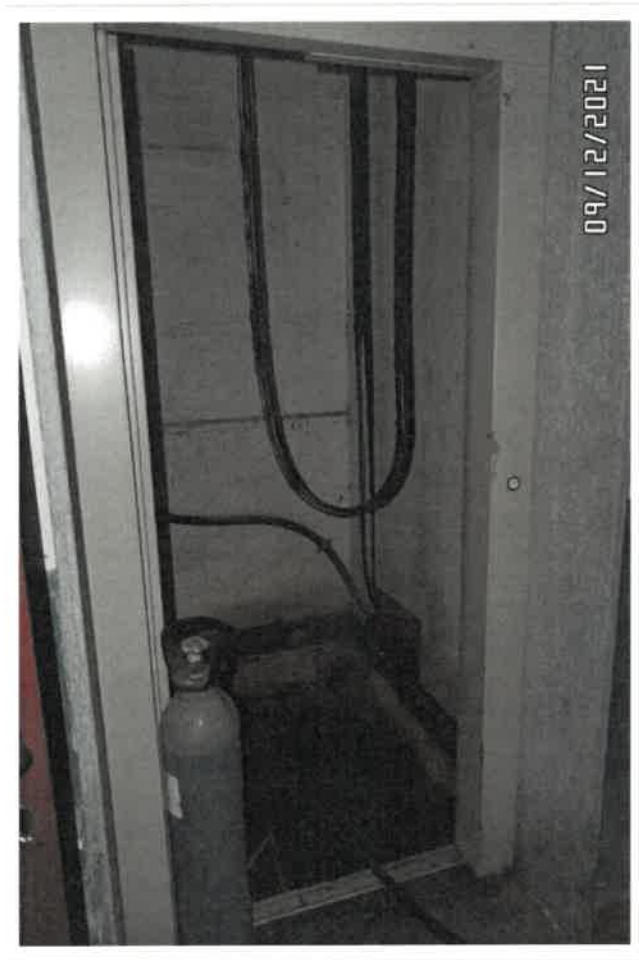
Ascensore fuori uso
