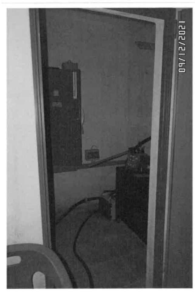
Locale motore ascensore
