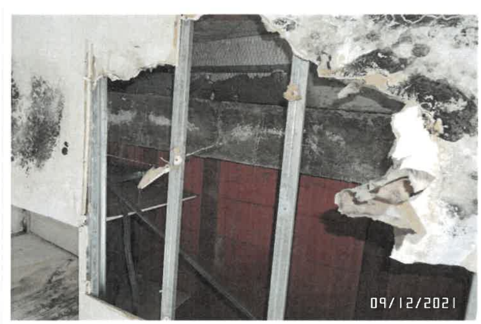
Particolare controsoffitto vano scala ammalorato Piano Secondo
