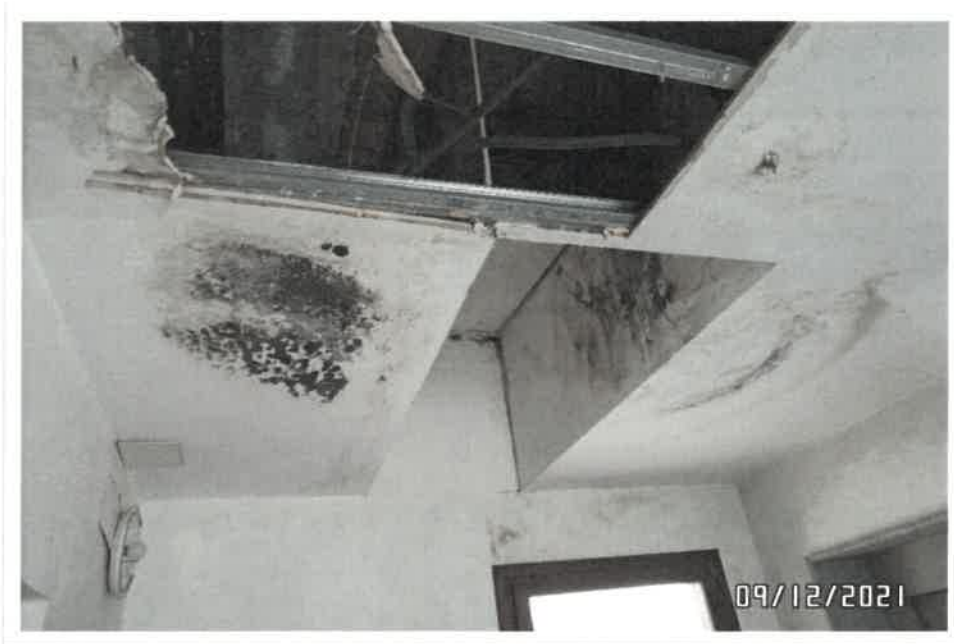
Particolare controsoffitto vano scala ammalorato Piano Secondo
