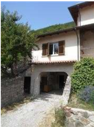
veduta del portone di ingresso all'unità immobiliare 992 sub. 3 (privo di serramento) con terreno pertinenziale
