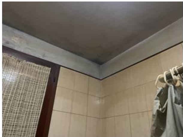
Foto n. 14 interno particolare muffa soffitto bagno
