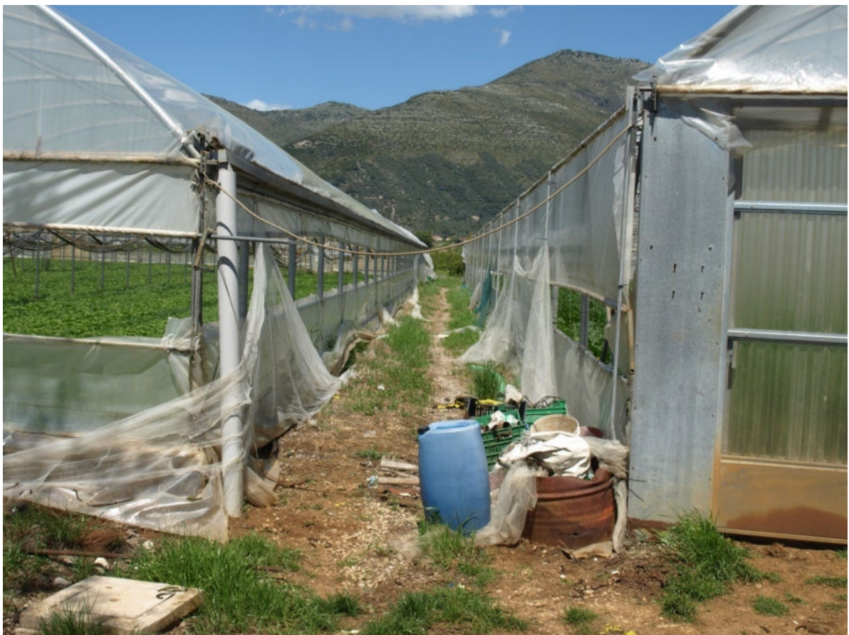
DISTACCO TRA SERRE 1-6 E 7-11
