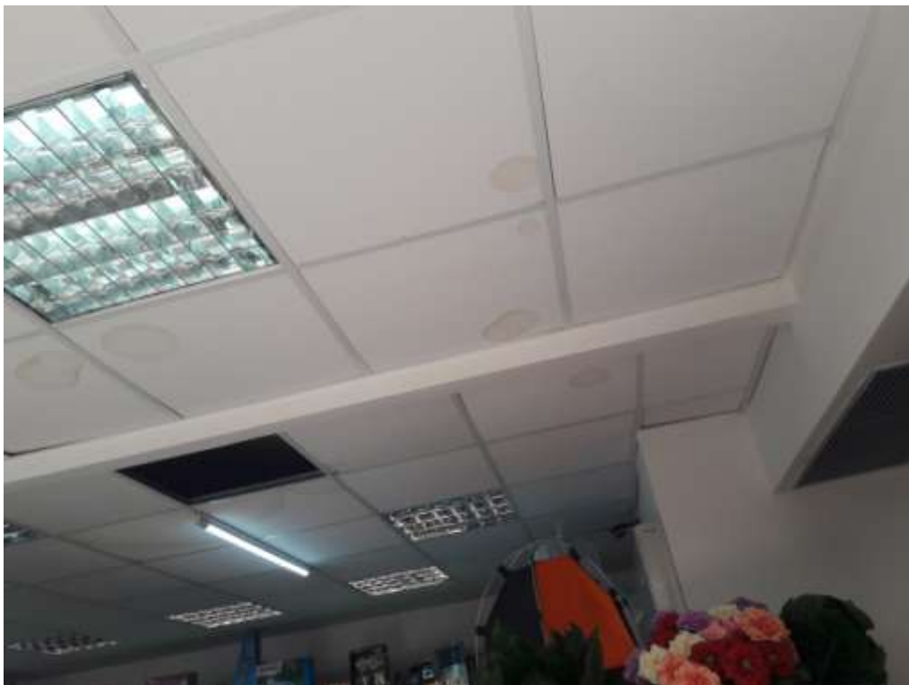
Foto 33 – Macchie di infiltrazioni di acqua meteorica limitrofe alla zona di copertura in plexiglass
