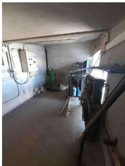
Foto 35 – Locale Tecnico (LT)
