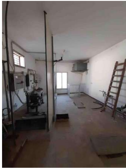
Foto 25 – Locale Tecnico (LT)
