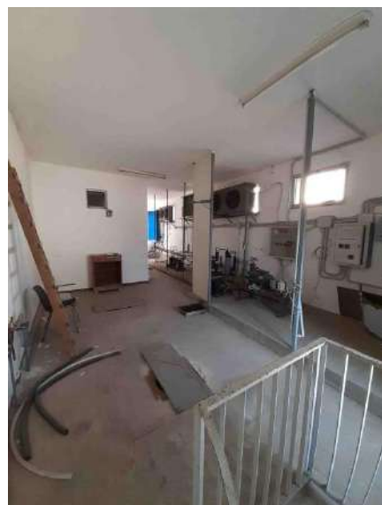
Foto 23 – Locale Tecnico (LT)
