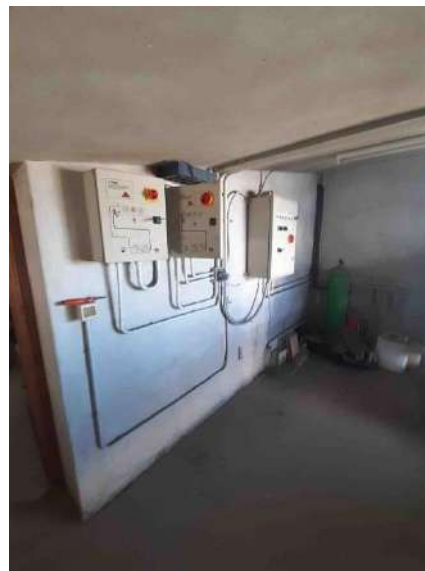
Foto 36 – Locale Tecnico (LT)
