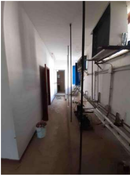
Foto 24 – Locale Tecnico (LT)
