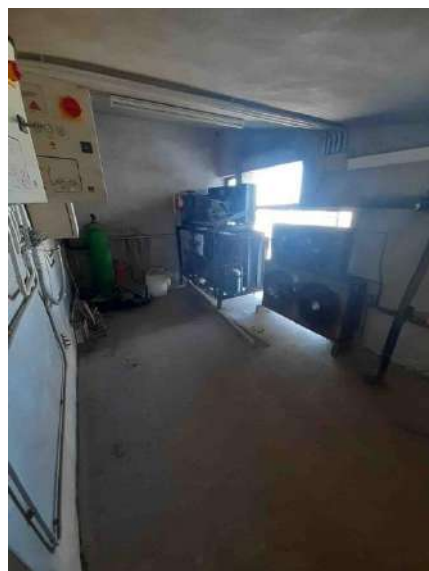
Foto 34– Locale Tecnico (LT)
