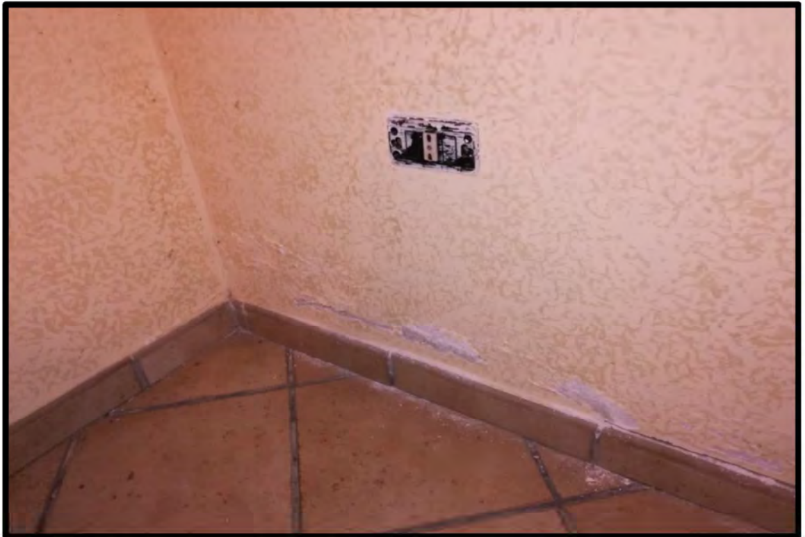
8 PARTICOLARE INTERNO UMIDITA PER RISALITA CAPILLARE SULLE MURATURE
