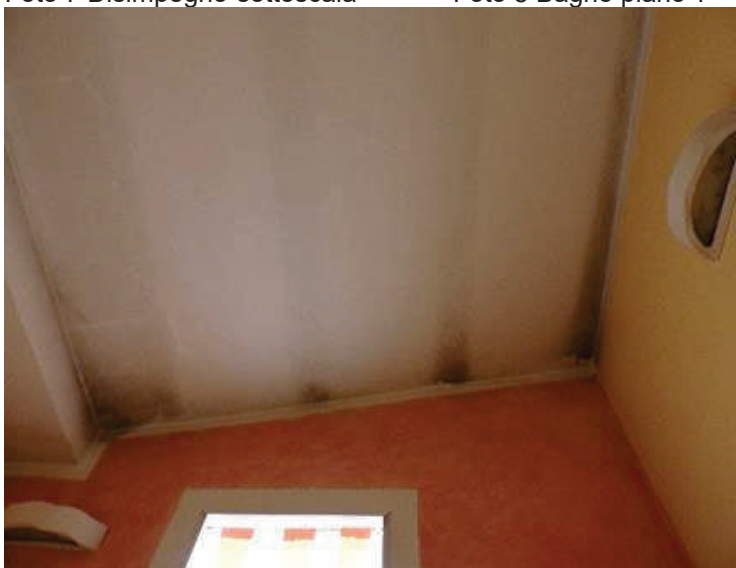
Foto 10 Muffe sul soffitto del vano scale
