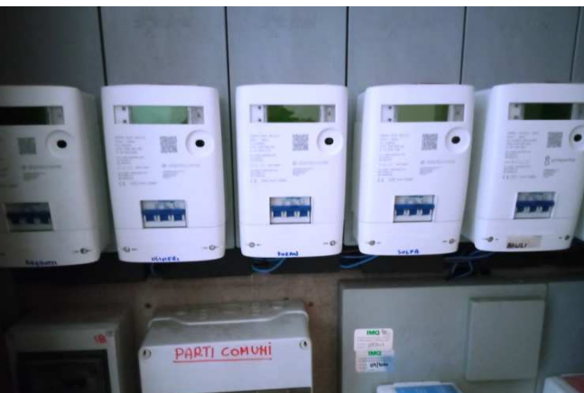
foto 22 - Utenza elettrica connessa (Zoran)
