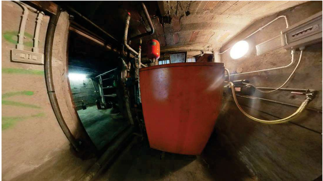
Foto 22 – Alloggio – Centrale Termica
