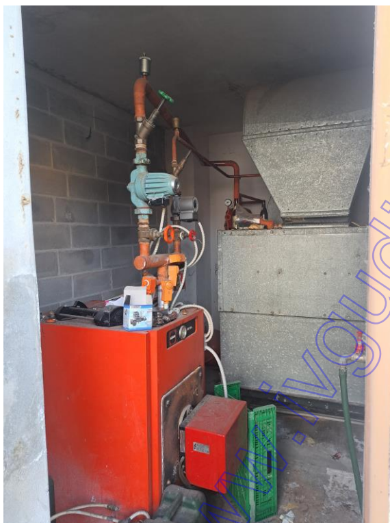
Centrale Termica erroneamente posizionata in vano condominiale
