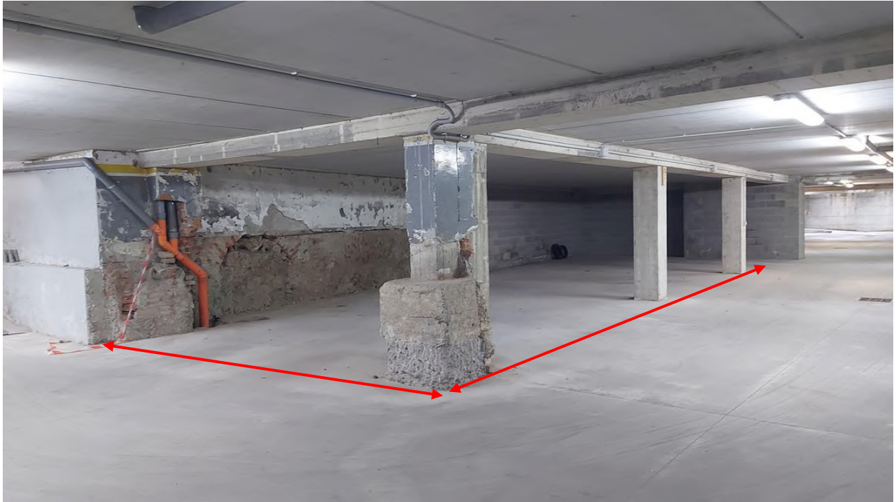
Foto 26 – Vista dal corridoio di manovra comune
