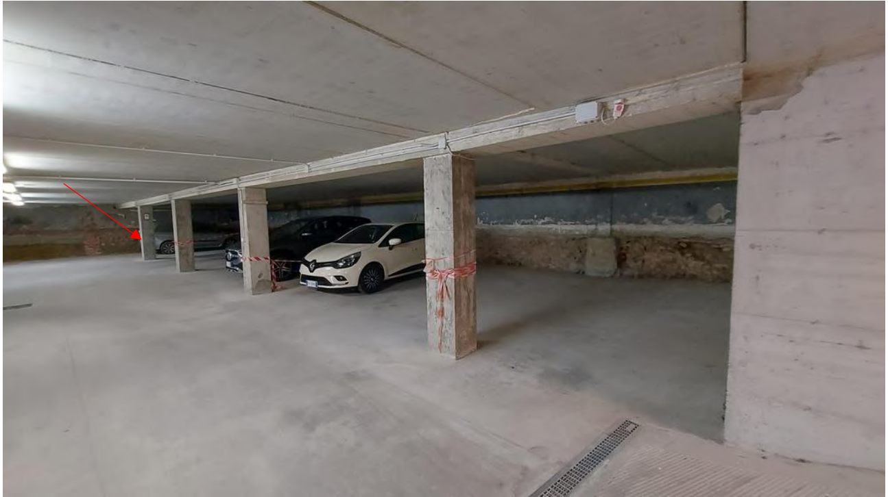
Foto 22 – Vista dal corridoio di manovra comune
