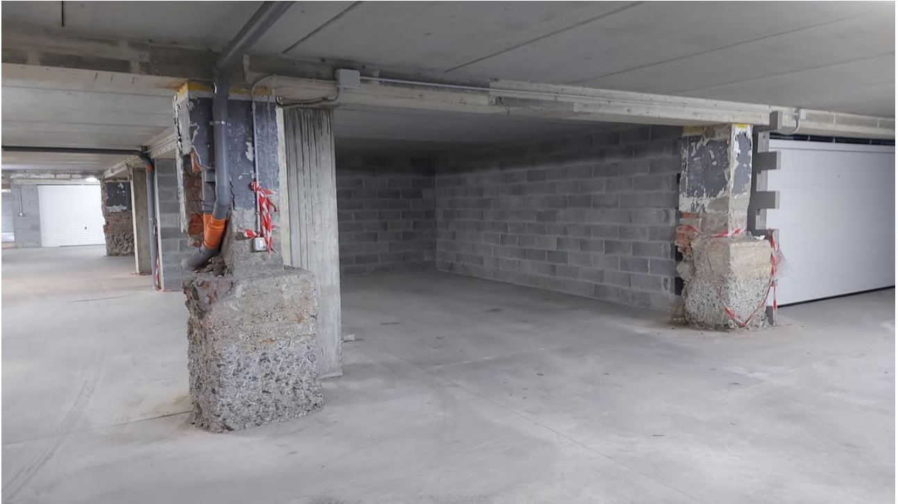
Foto 28 – Vista dal corridoio di manovra comune
