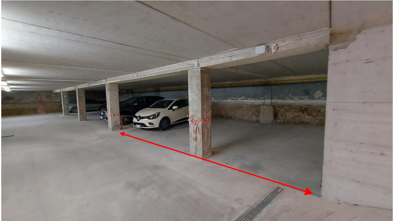
Foto 24 – Vista dal corridoio di manovra comune
