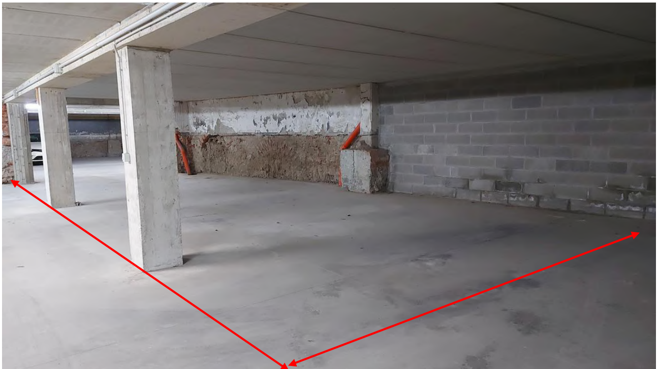
Foto 27 – Vista dal corridoio di manovra comune
