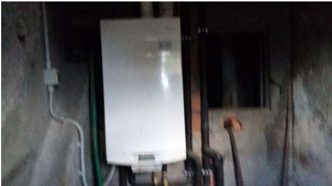
Foto n. 8. Piano Terra. Centrale Termica
