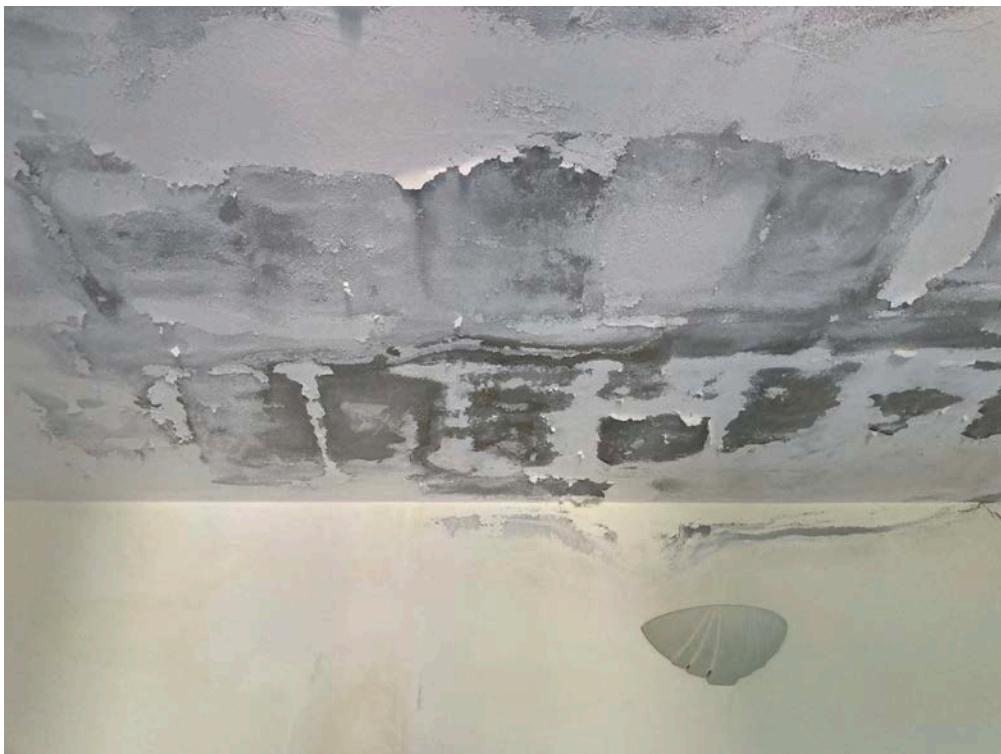
Foto n. 24 – particolare ammaloramento intonaci soffitto della seconda camera al Piano Terra
