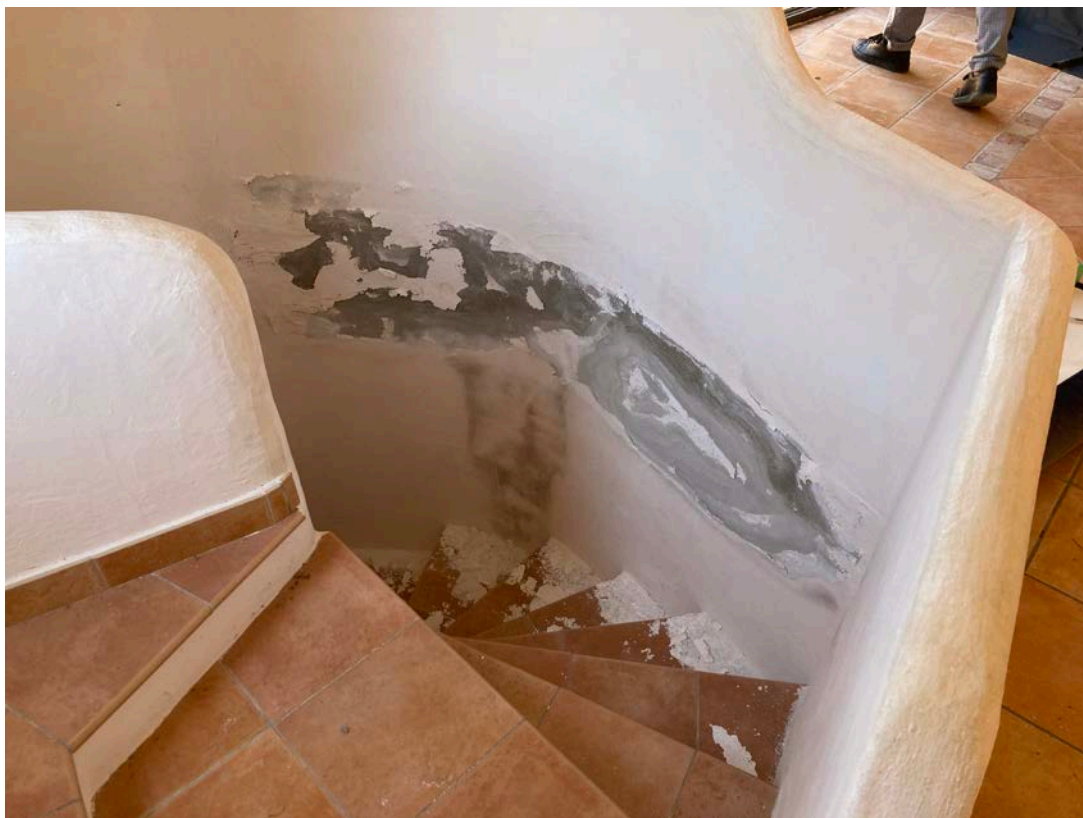
Foto n. 13 – particolare della scala, con evidente ammaloramento degli intonaci
