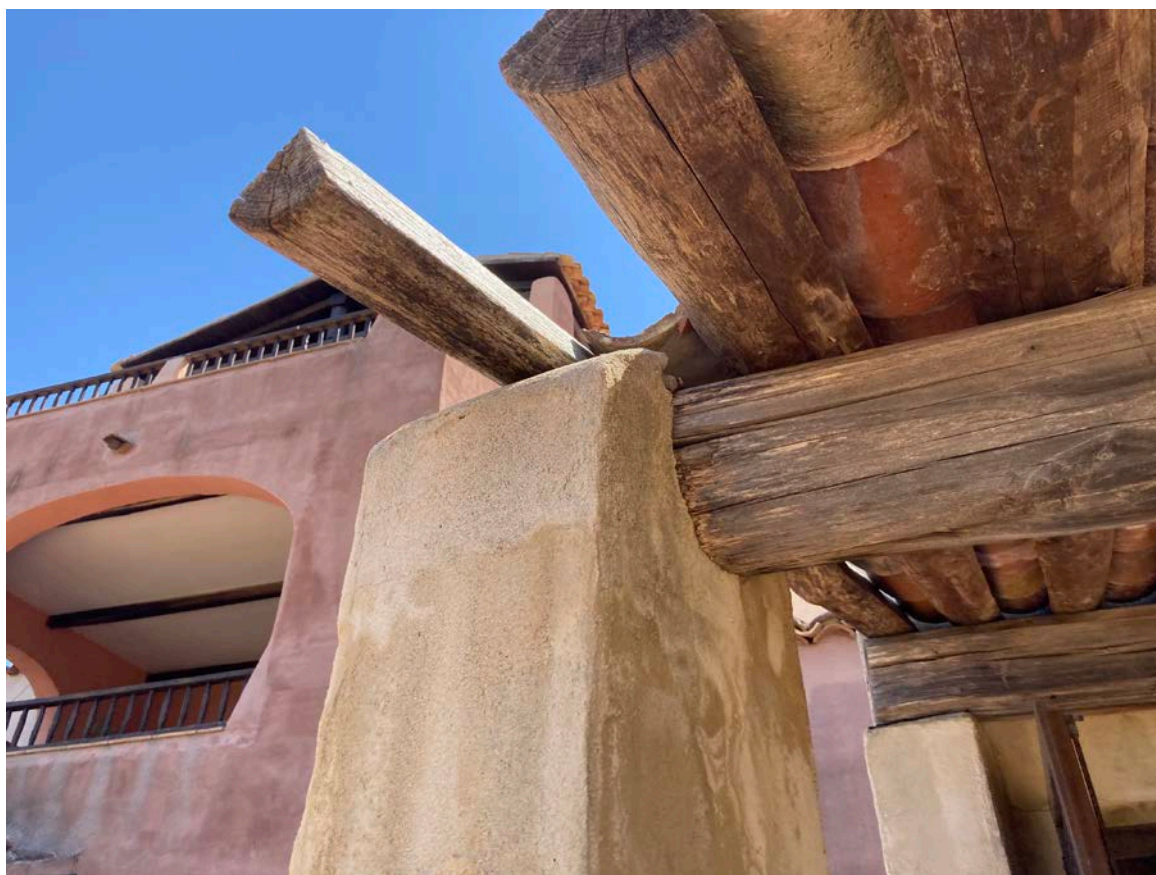
Foto n. 28 – altro particolare ammaloramento soglie nel terrazzo al Piano Terra
