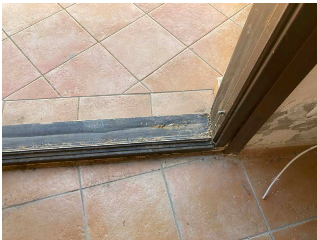
Foto n. 14 – particolare scorrevole piano 1° e ammaloramento intonaci
