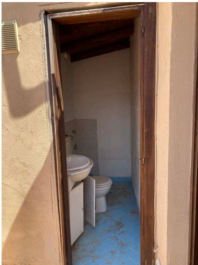
Foto n. 18 – altra veduta dell'abuso
