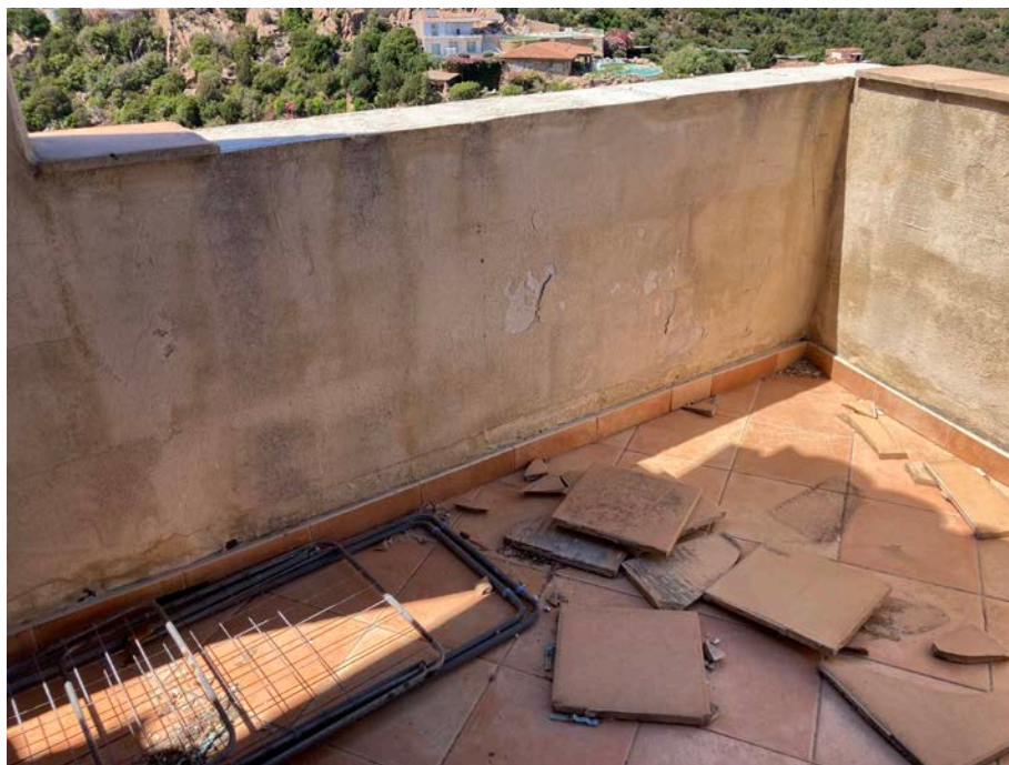
Foto n. 26 – particolare ammaloramento soglie nel terrazzo al Piano Terra
