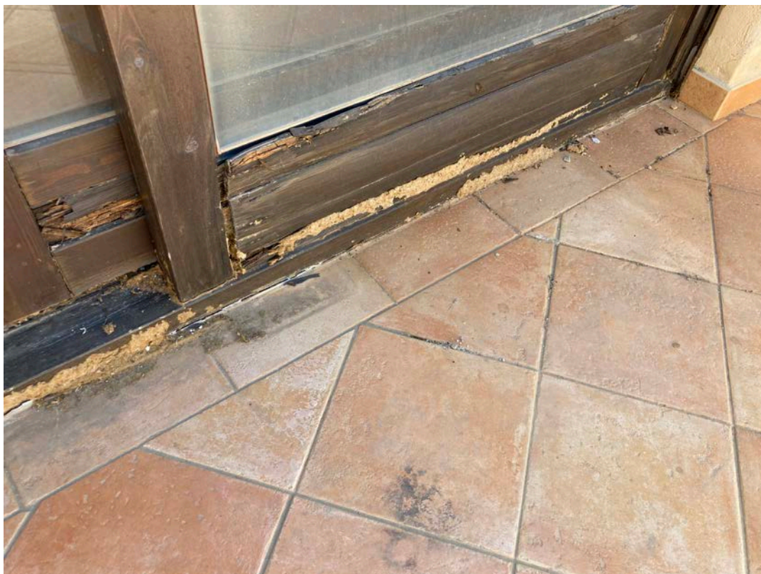
Foto n. 15 – altra particolare scorrevole piano 1° (da sostituire)
