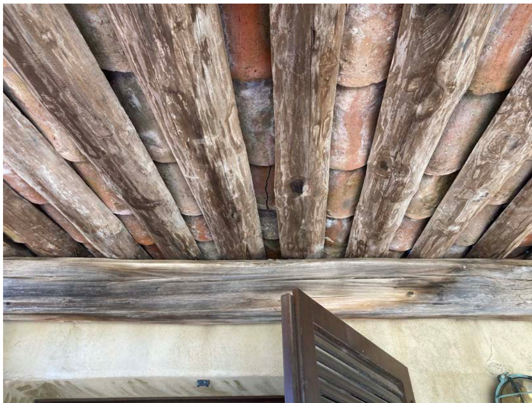
Foto n. 27 – particolare ammaloramento tettoia nel terrazzo al Piano Terra
